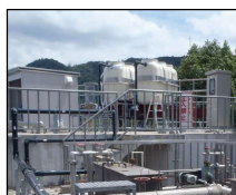
浄化(排水処理)
