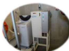
BUVITT設置状況。100V電源、水道ホースを取り付けるだけ。
